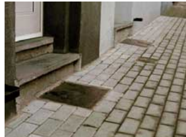
Foto 11. De voeg tussen trottoir en huis is zeer goed afdichtend.
