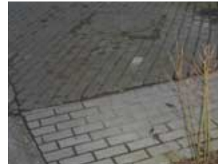
Foto 9. Combinatie van een oude met een nieuwe verharding. De oude is aan vervanging toe. Bemerkt de brede vuile voegen en het reliëfverschil, waar zich organisch materiaal verzamelt.
